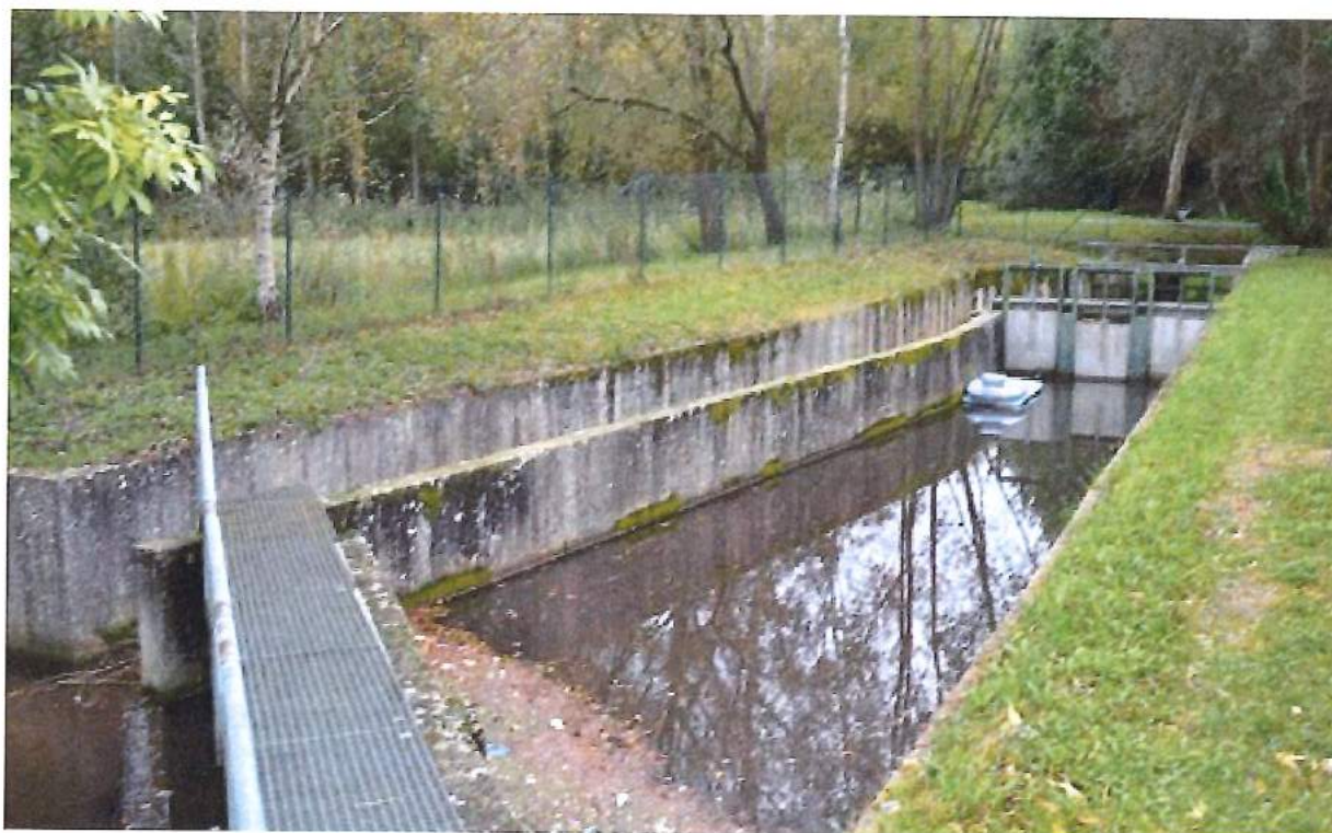
Décanteur du ru de Vauhalla
